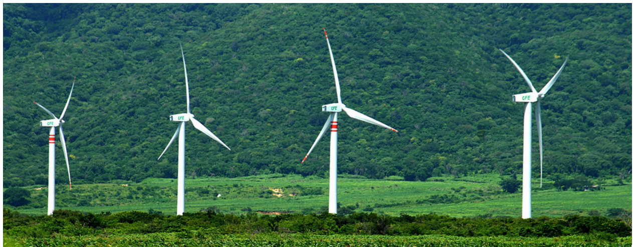
Central eólica. La Venta, Oaxaca. Comisión Federal de Electricidad.
